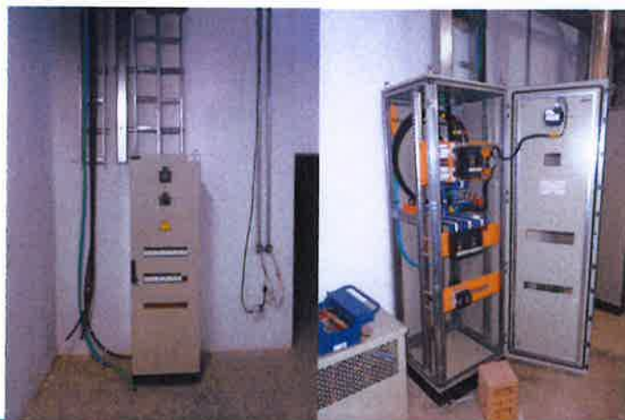
Interior - Quadros elétricos de distribuição
