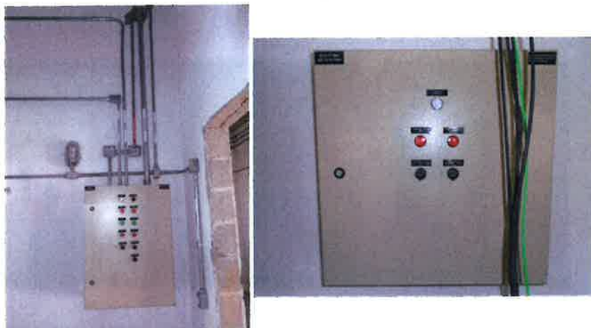
Interior - Quadros elétricos do ar condicionado
